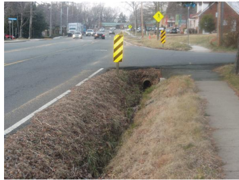
b) Hazardous non-traversable ditch
